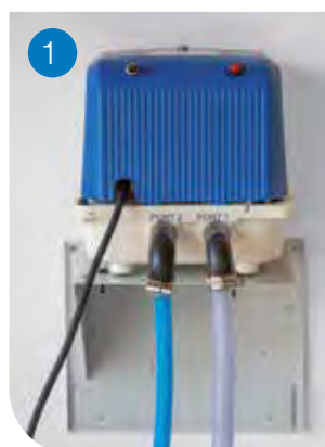
Im Gebäude installiert auf einer Konsole
